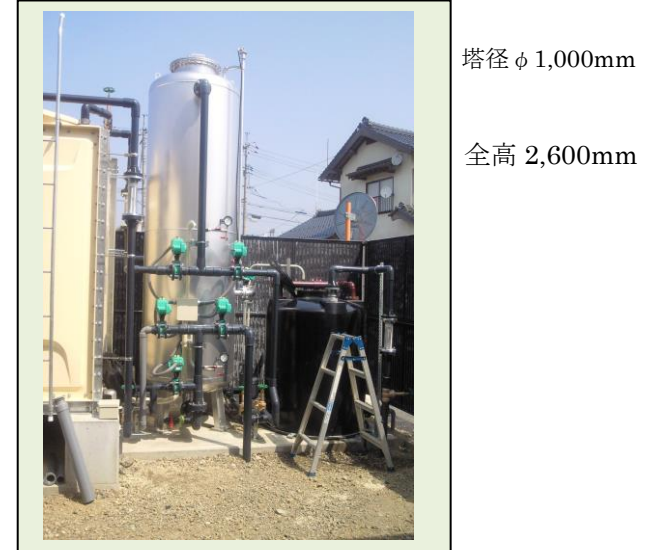
図-2. ゆらり館「生物ろ過塔」
