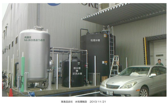
写真-1 京都市の高濃度マンガ（Mn）除去施設
